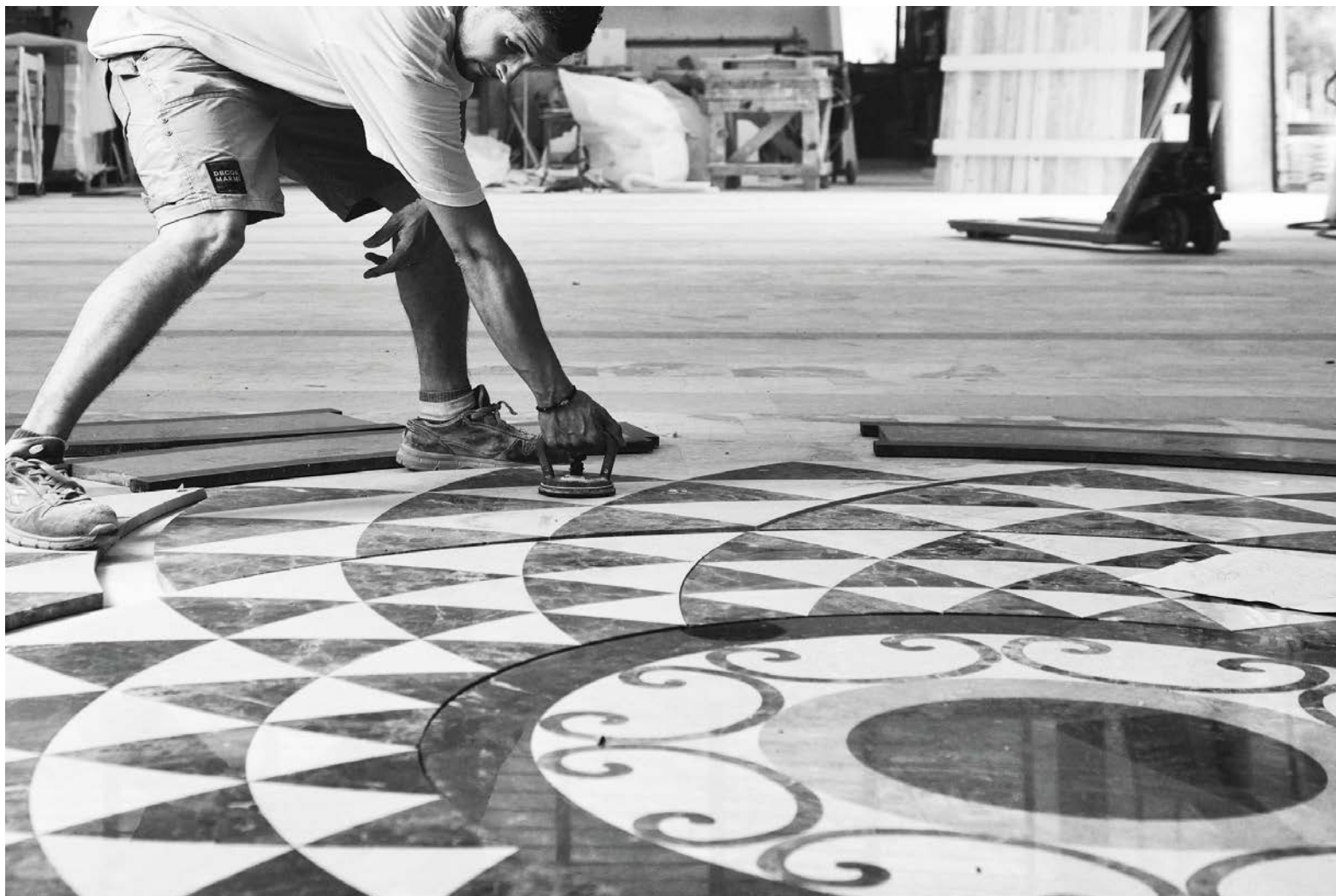
Dettaglio di un maestro posatore al lavoro. Detail of a master installer at work
